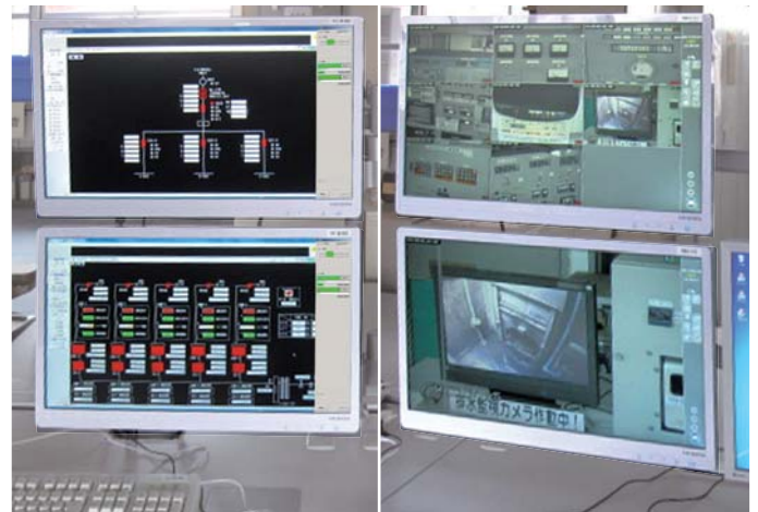
中央監視システム
