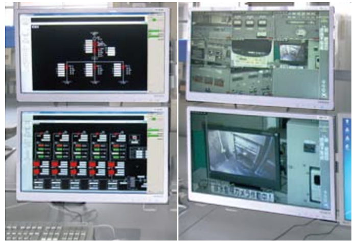
中央監視システム
